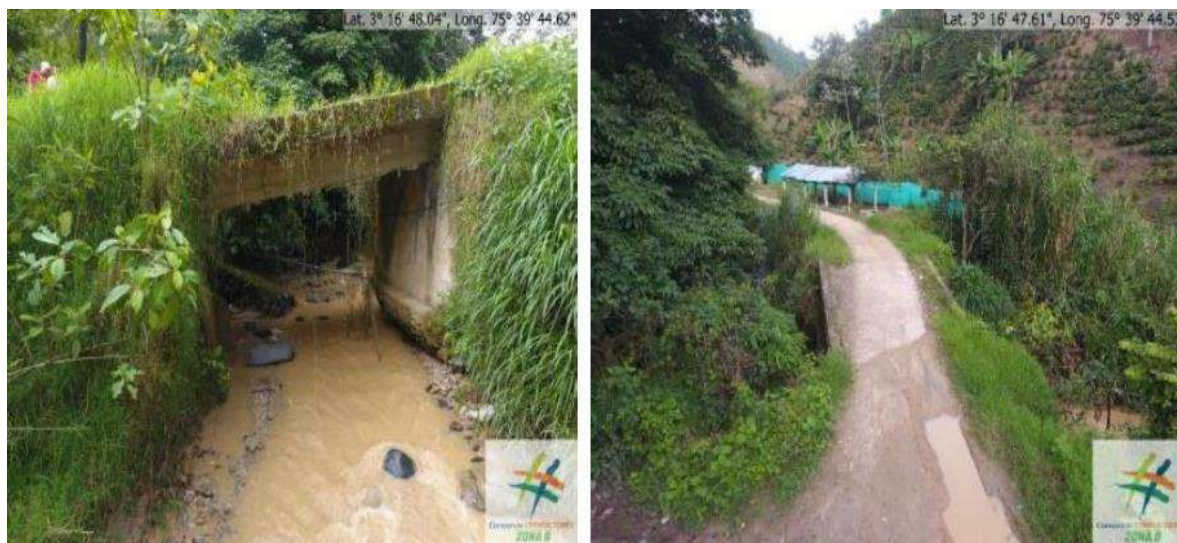
Ilustración 3 Fotografías estado puente en año 2020
