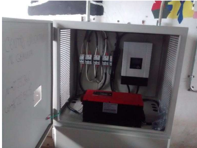
Ilustración 17 Montaje típico de instalación del Regulador/controlador de carga e inversor en gabinete
