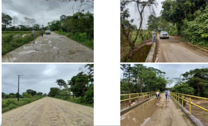
Ilustración 1 Estado actual de la vía Fuente Fotografías de JFR ingeniería civil
