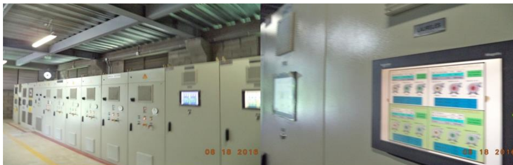
Ilustración 28. Cuarto de control
