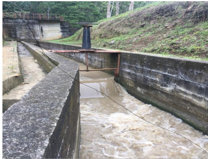
Ilustración 6. Aducción ubicada en la Bocatoma
