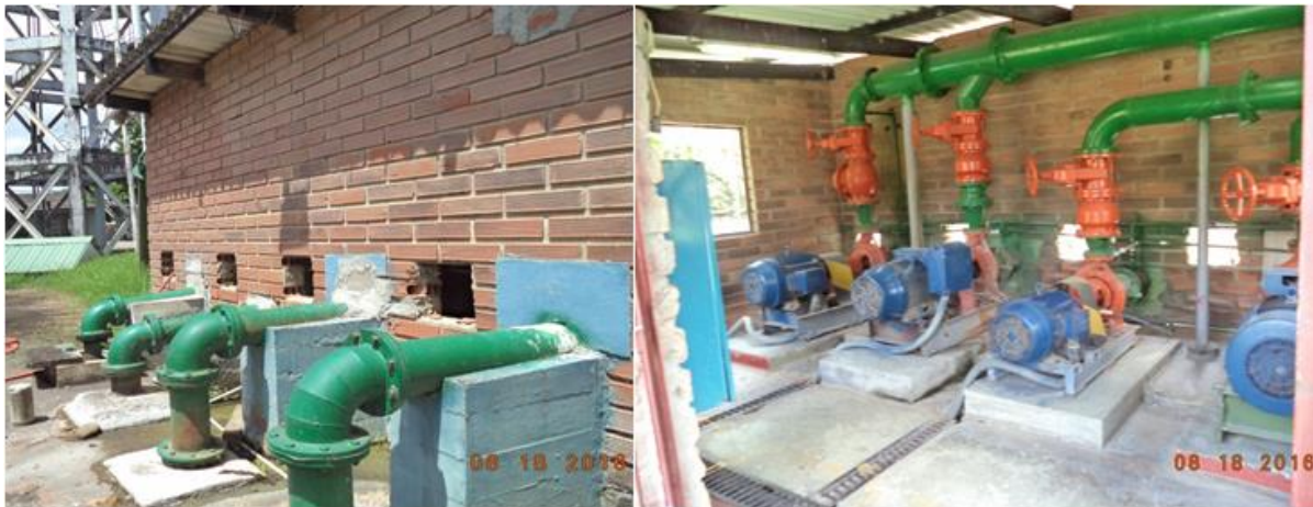
Ilustración 31. Motobombas de superficie suben el agua al tanque elevado Centro
