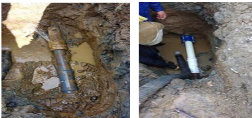
Ilustración 39 Reparación de Fuga 3" asbesto cemento, circuito 45/379400. Cr 98 y Cl 98 esquina. Frente almacén Gran Campeón.
