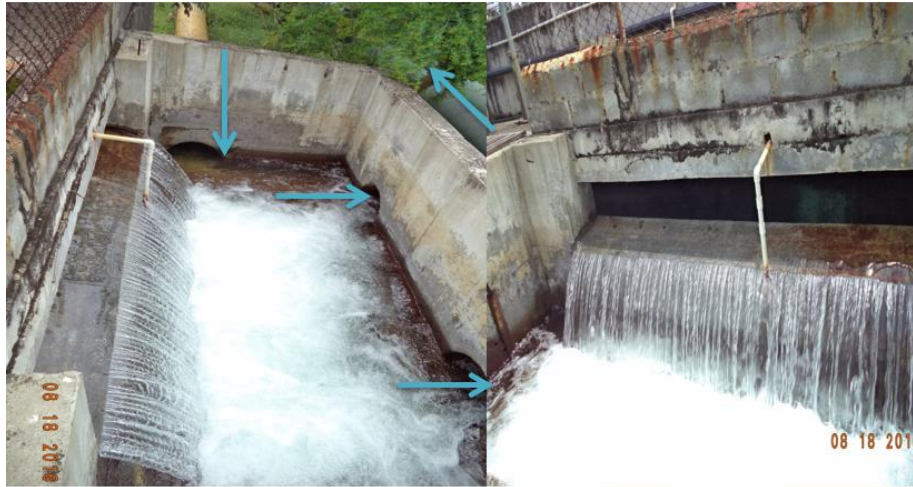
Ilustración 20 Tanque de cloración
