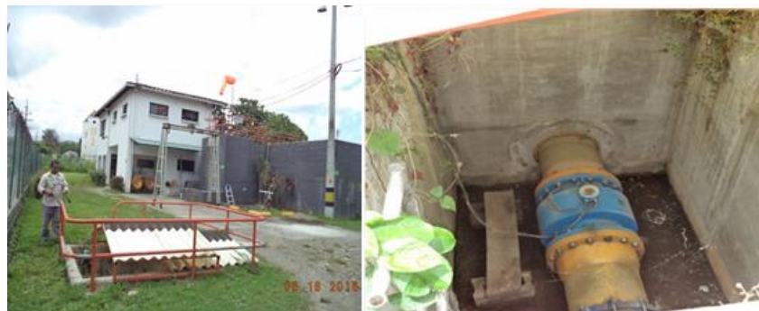
Macromedidor en la entrada de la planta de producción de agua potable
