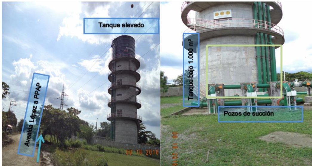
Ilustración 26 Tanque elevado de concreto 20 de enero de 750 m 3
