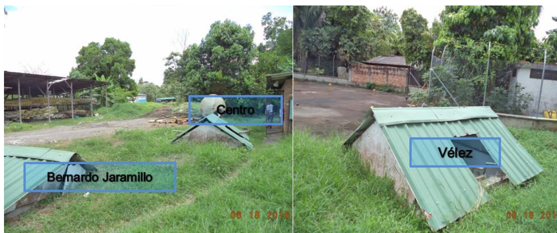
Ilustración 33. Macromedidores salidas del Tanque Centro
