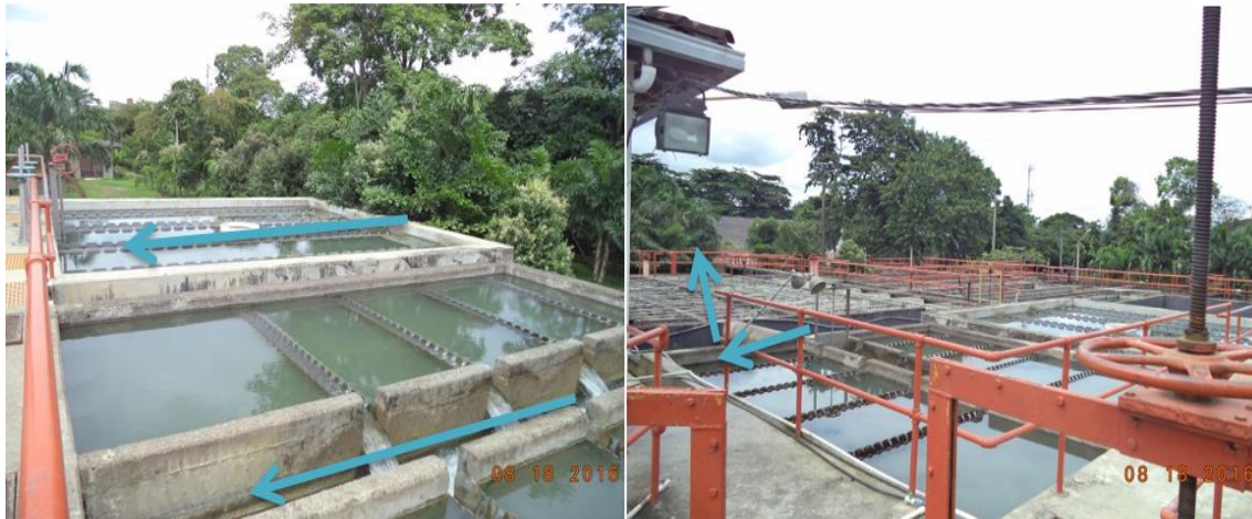
Ilustración 12. Presedimentadores MODULOS ANTIGUOS Y NUEVOS
