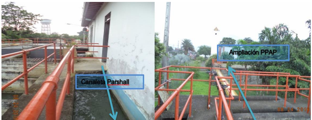
Ilustración 15 Distribución del agua de la canaleta parshall a los floculadores.
