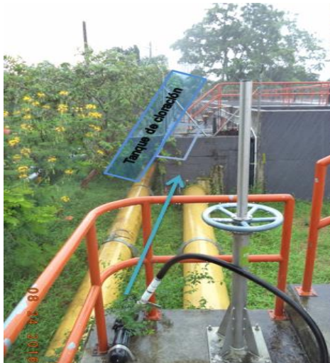
Ilustración 19 Filtros de la unidad de la PPAP ampliada se une con los filtros antiguos y se vierten al tanque de cloración
