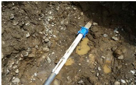
Ilustración 44 Reparación de Fuga 3" asbesto cemento. Cr 99 con Cl 99 esquina, calle del sindicato.
