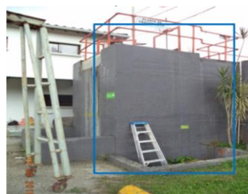
Cámara de aquietamiento
