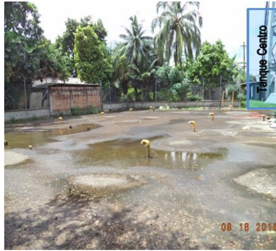
Ilustración 30. Salida tanque de cloración al tanque semienterrado de 1.500 m 3 ubicado en la sede operativa – tanque Centro a 150 ms de la PPAP
