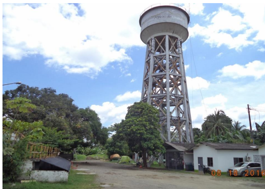
Ilustración 32. Tanque elevado Centro de 500 m 3 en la sede operativa
