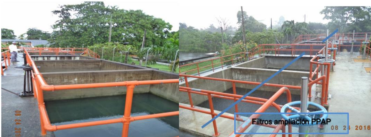
Ilustración 18 Filtros unidades planta antigua y nueva
