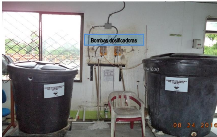
Ilustración 14 Bomba dosificadora y tanques almacenamiento coagulante
